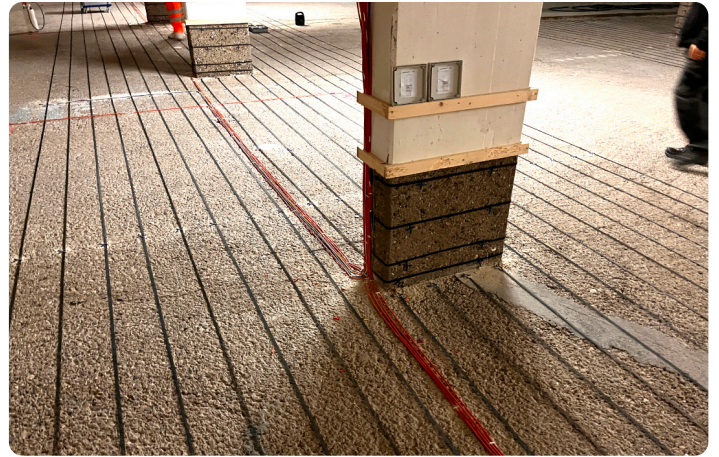
Bandanoden und Verkabelung an den Stützen und auf dem Boden
