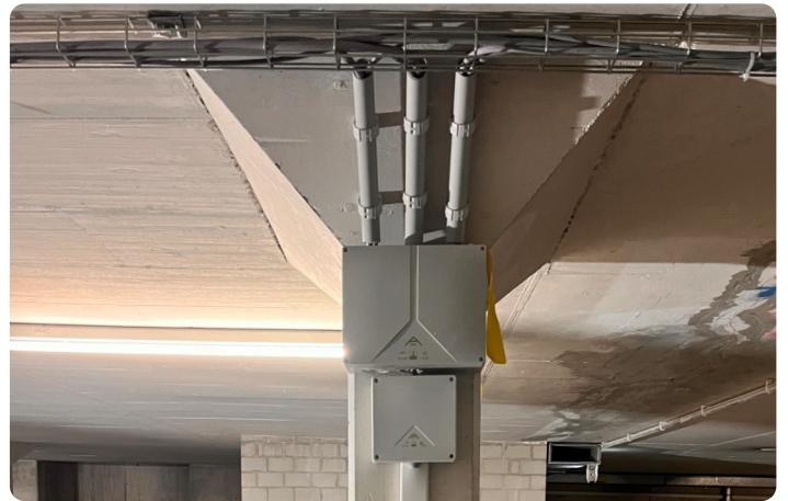
Kabelführung in Lehrrohren und Trasse bis zum Steuerschrank
