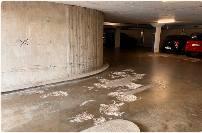
Betonabplatzungen im Einfahrtsbereich vor der Instandsetzung
