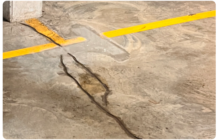
Sichtbare Trennrisse vor der Instandsetzung
