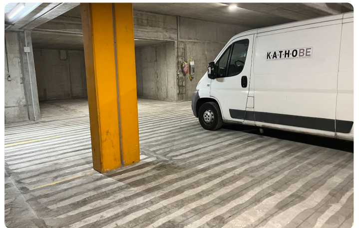
Einstellhalle nach der fertigen KKS-Installation
