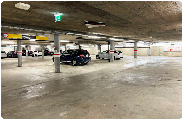
Zustand der Einstellhalle vor der Instandsetzung
