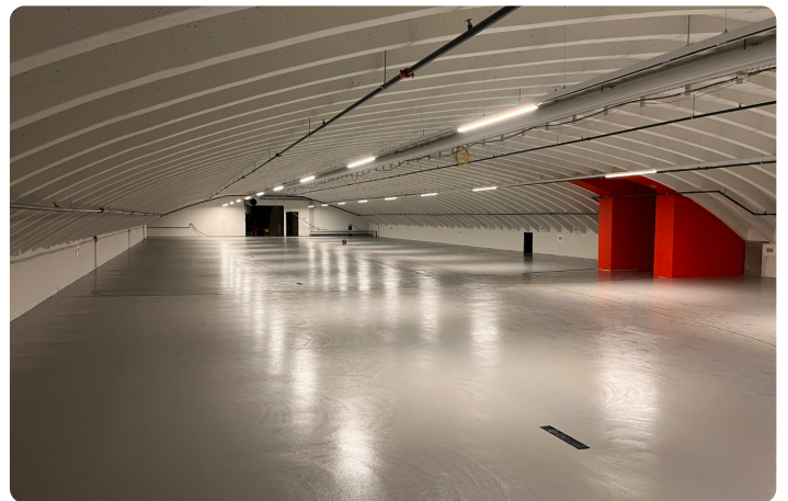
Die KKS-Installation ist nach der Beschichtung nicht mehr sichtbar
