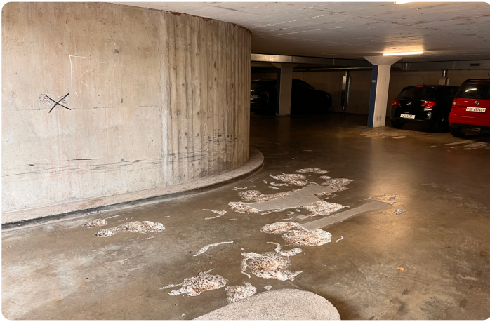
Betonabplatzungen im Einfahrtsbereich vor der Instandsetzung
