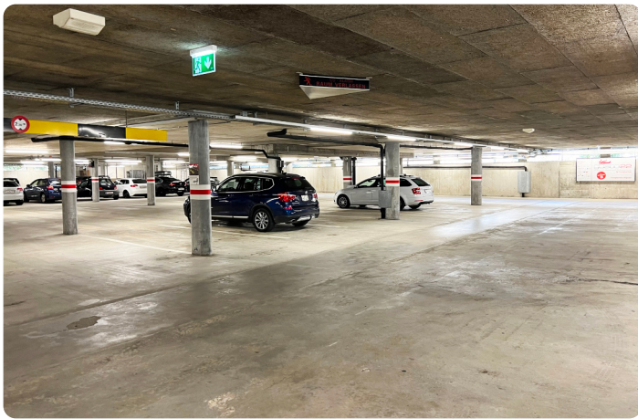
Zustand der Einstellhalle vor der Instandsetzung
